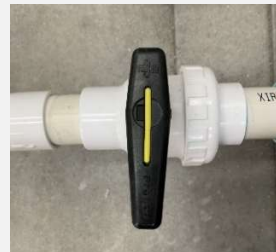
Poignée dans le sens contraire de la tuyauterie = valve fermée
